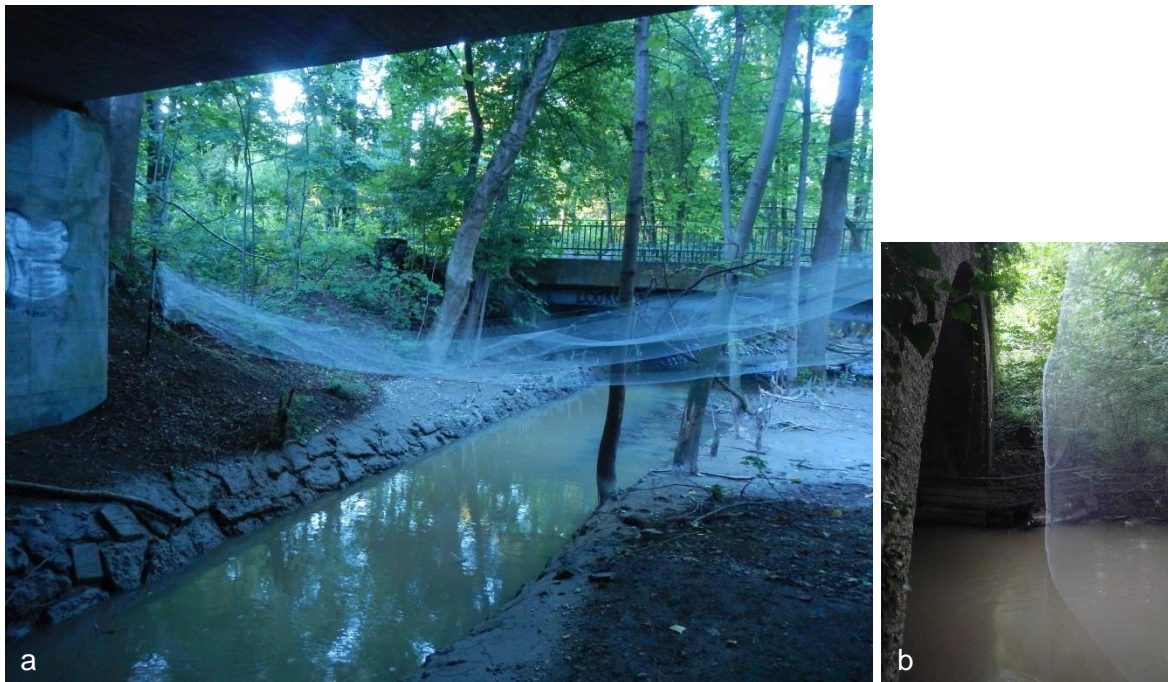
Abb. 4: Aufbau Netzstandorte (a) Bauwerk 0/3 Schwabinger Bach und (b) 01 Garching Mühlenbach
